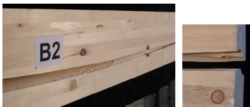
Slika 6.10 - Smičući lom usled odvajanja drvene mase između godova (nosač B2)
