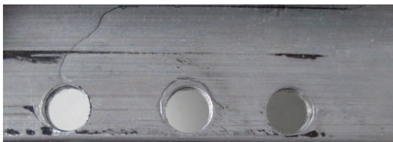
Slika 7.14 Putanja prsline na vertikalnom zidu levog pojasa ramenjače (bočni pogled)
