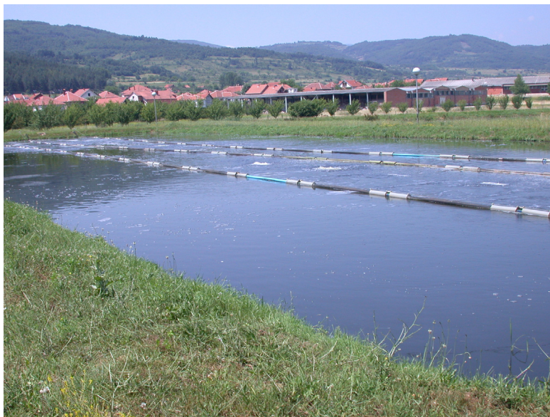
Slika 6. Jedna od biolaguna za aerisanje vode u PPOV "Beleš" kod Dimitrovgrada.
