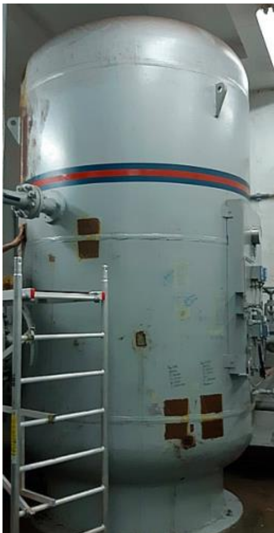
Slika 4. Sud pod pritiskom pre reparacije
