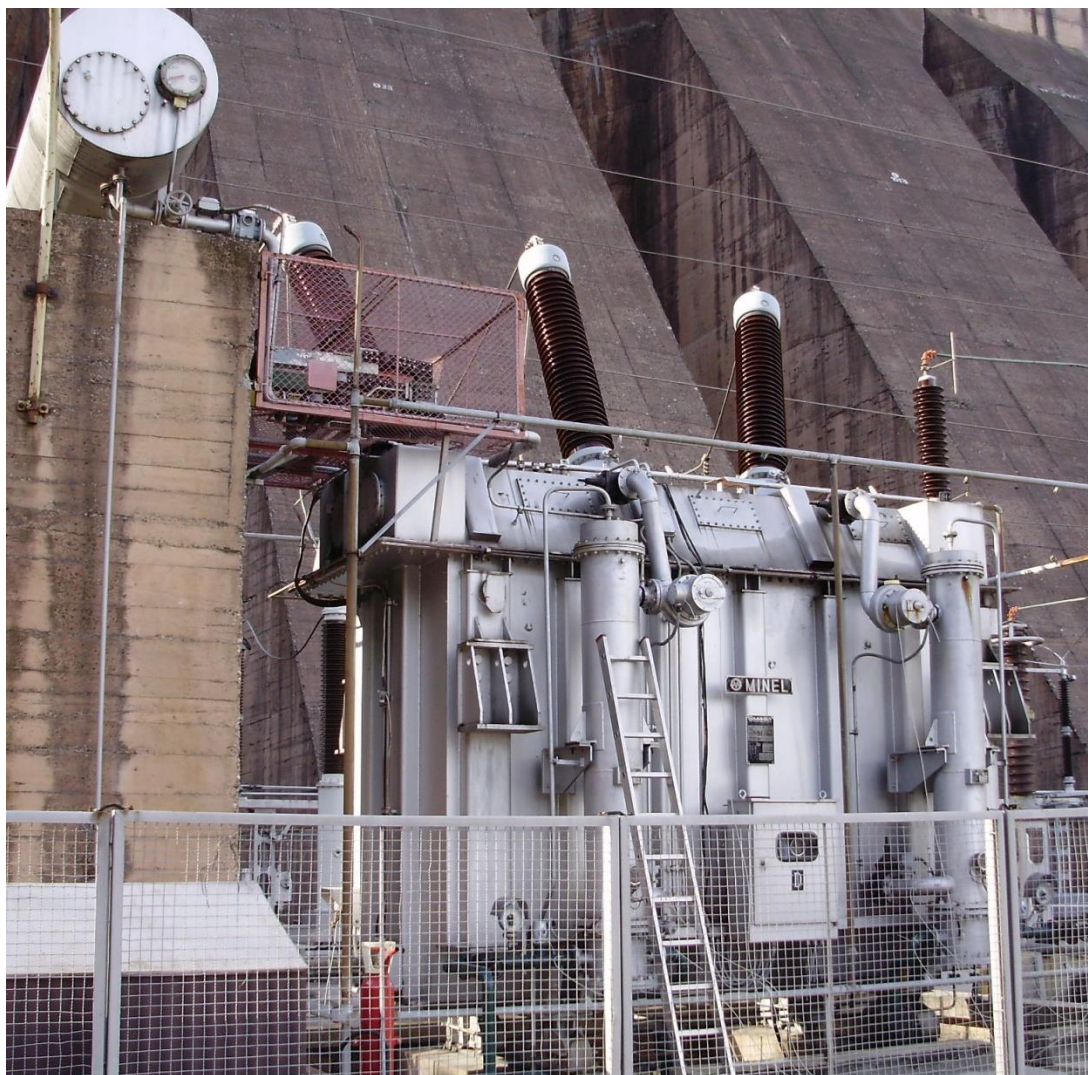
Сл. 6.1 – Блок трансформатор 100 MVA на РХЕ „Бајина Башта“
