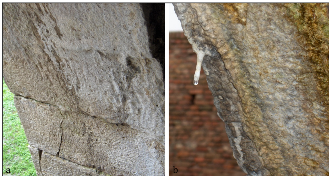
Sl. 117. Površine blokova SZ fasade Kralj kapije prekrivene svetlim korama; a) tanke bele prevlake na površini krečnjaka; b) kora u formi kalcine sa recentnim stalaktitom (Arhiva ZZSKGB)
