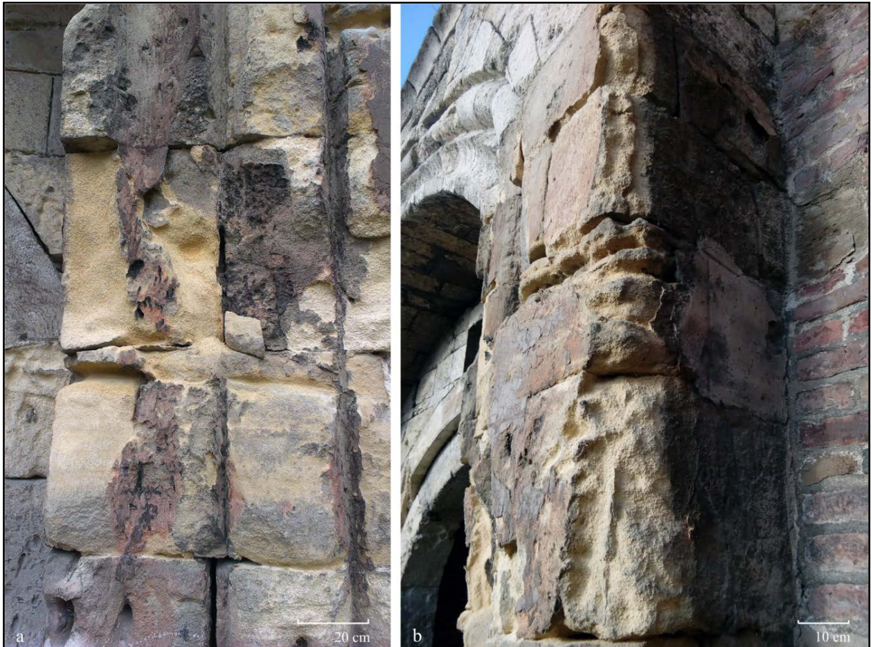
Sl. 62. Narušen integritet blokova profilisanog portala - istočni deo JI fasade; a) intenzivna zrnasta dezintegracija i reljefno raspadanje svih novootvorenih površina grainstone nakon odvajanja kora ili ljuski; b) zrnasta dezintegracija i diferencijalno raspadanje ivičnih blokova grainstone
