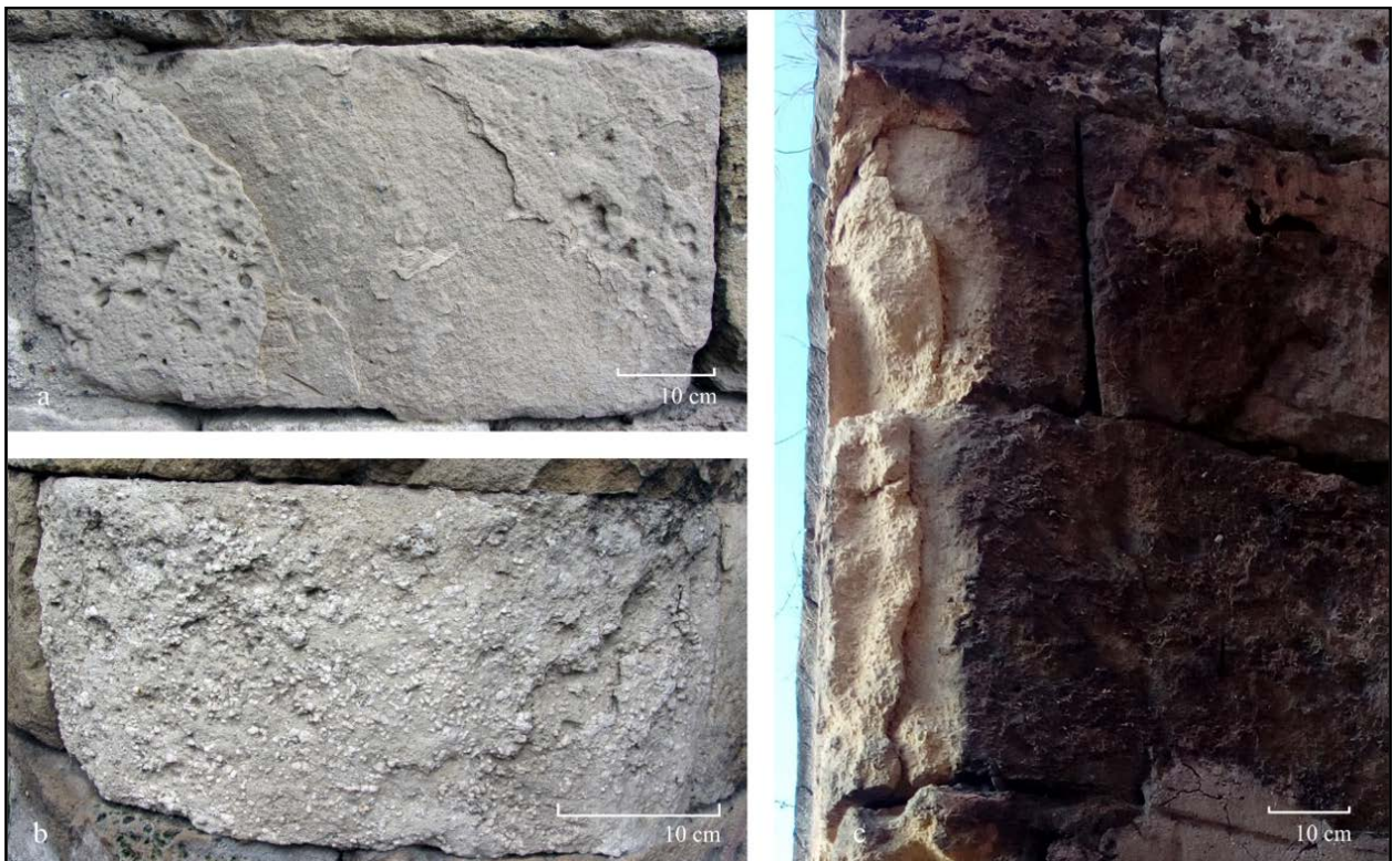
Sl. 63. Degradacija blokova krečnjaka u formi odvajanja: a) ljušpanje grainstone istočnog dela SZ fasade; b) ljušpanje algalnog rudstone istočnog dela SZ fasade; c) ljuškanje visokog intenziteta blokova grainstone sa ostacima crnih kora koje prate morfologiju kamena - istočni deo JI fasade
