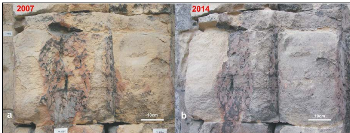
Sl. 115. Progresivno raspadanje grainstone na istočnoj polovini II fasade Mračne kapije (Franković et al., 2014)
