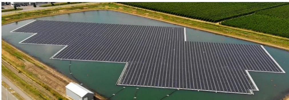
Slika 2.2. PFN elektrana u Holandiji, čija je instalisana snaga 1.85 MWp [26]
