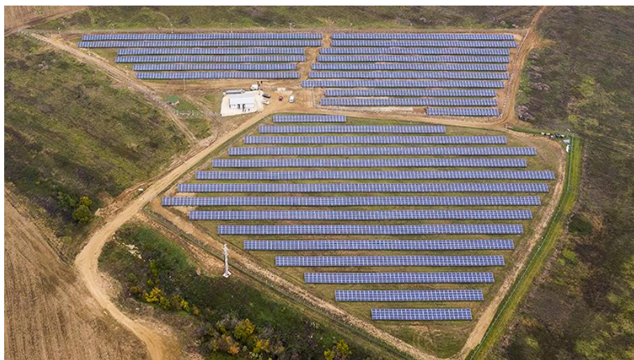
Сл. 2.6 Фотонапонска електрана (извор: Solaris Energy )
