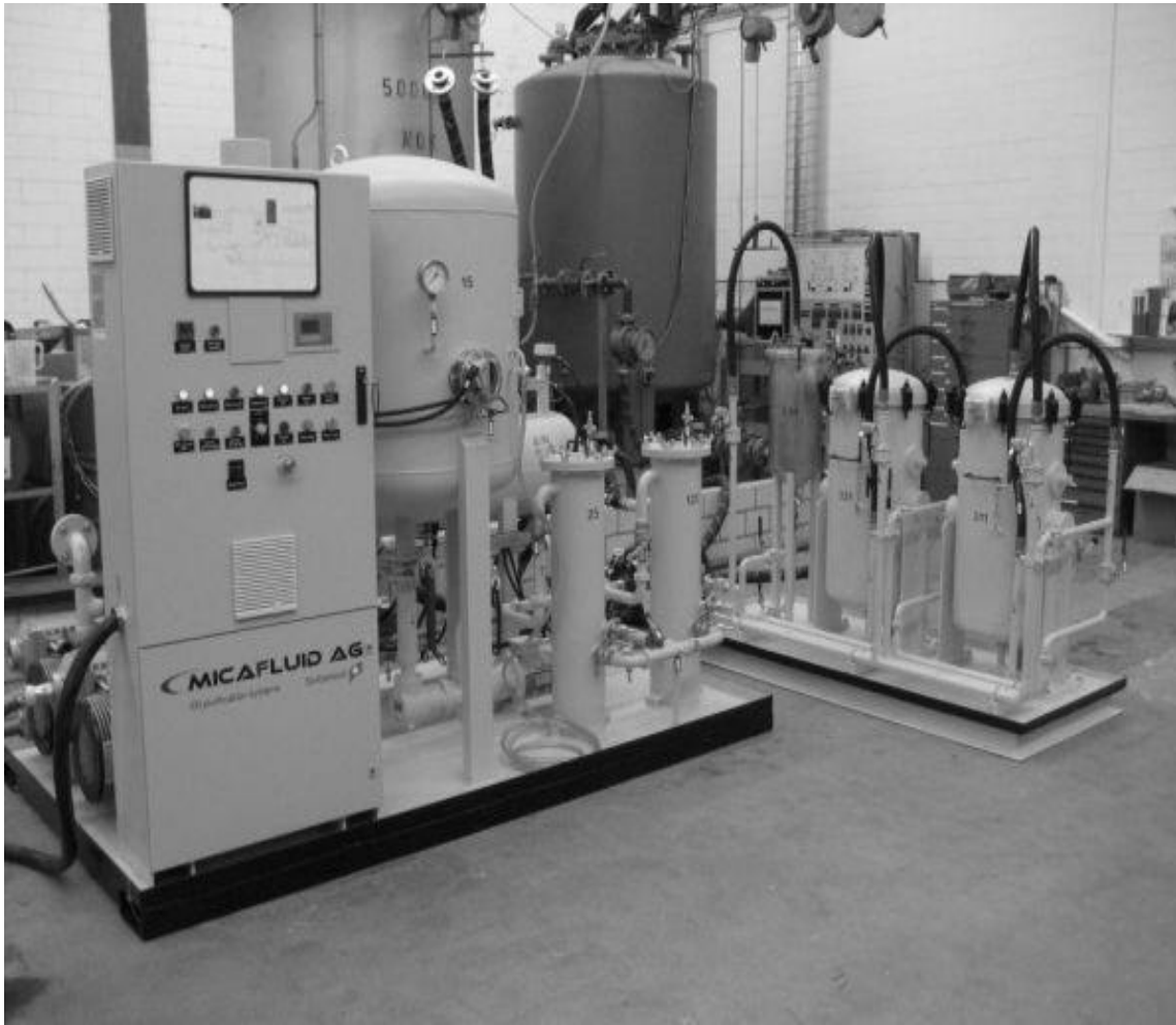
Slika 7.2 Uređaj VH-312 za regeneraciju transformatorskih ulja firme MICAFLUID AG
