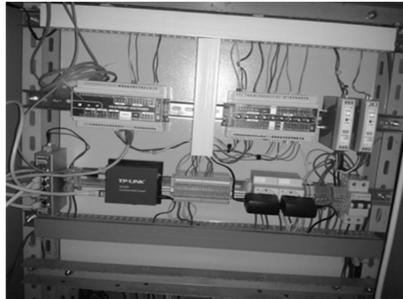
Sl. 6.11 - Na slici je dat prikaz procesorske jedinice: ethernet kontroler, U/I galvaniski izolovan modul, mrežni ruter, optički konvertor i dva modularna napajanja.
