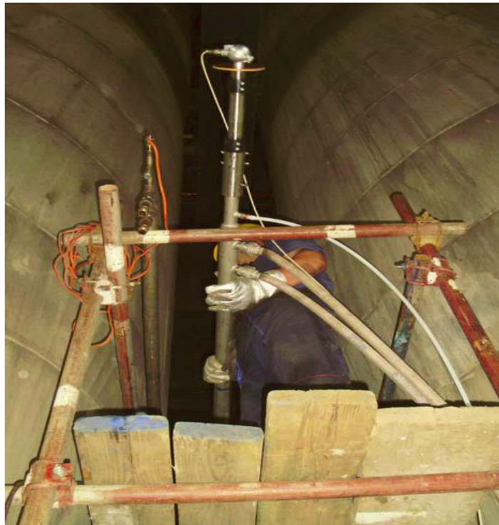
Slika 6.4. Primena na licu mesta u termoelektrani merno - eksperimentalne tehnike sistema pirometar - cev (zajedno sa sistemom za hlađenje).
