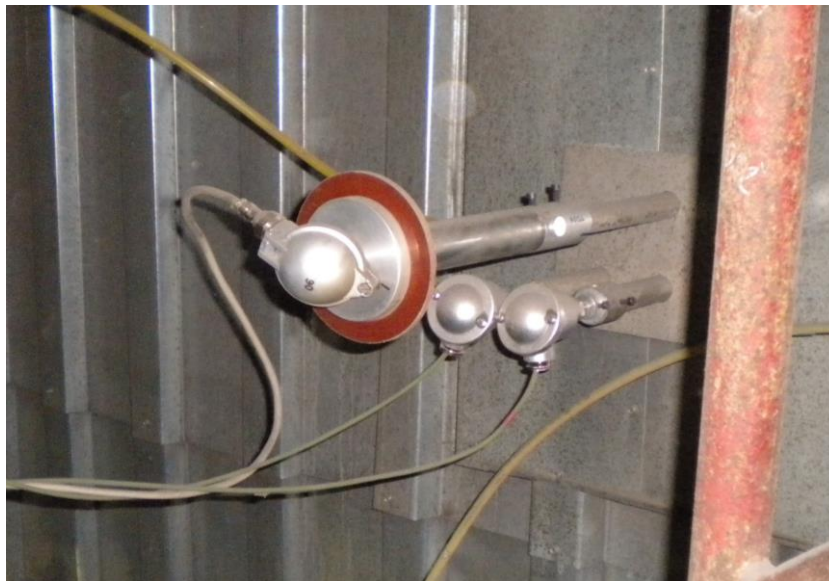
Slika 6.9. Kontrolni sistem na zidu kotla koji se sastoji od dvobojnog pirometra i dva termopara.
