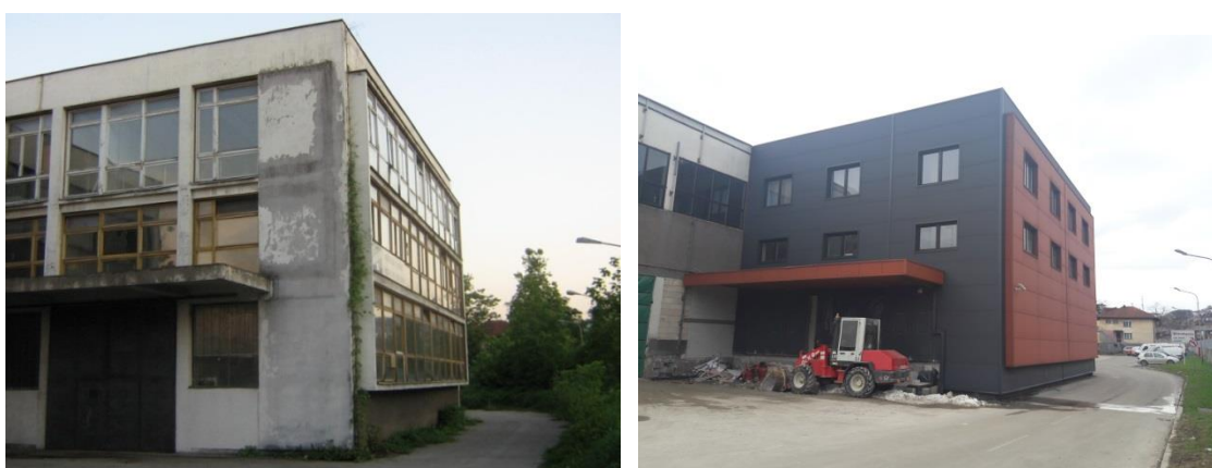
Слика 4.21. Северозападни део објекта монтаже са улазом пре трансформације (лево) и после трансформације (десно)
