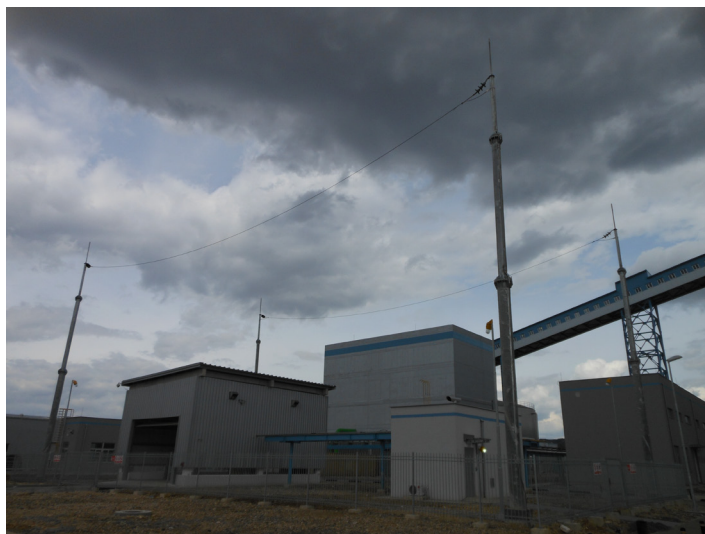
Слика 6.1 – Фотографија екстерног система заштите складишта водоника у ТЕ Станари (РС-БиХ)
