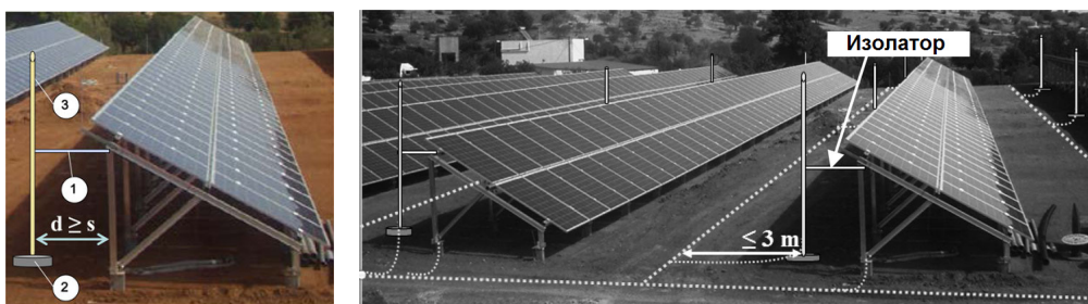
Слика 6.2 – Заштита соларних електрана од директних атмосферских пражњења примјеном екстерног система заштите [197]
