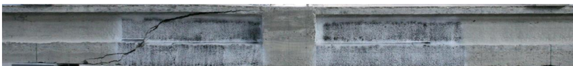
Slika P .4-10: 265-135/65-2: Prikaz prslina nakon loma grede: na južnom (a) i na severnom licu grede (b)
