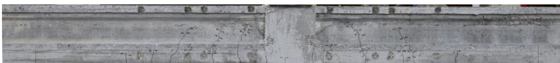
Slika P .8-10: 265-135/65-3: Prikaz prslina na južnom licu grede nakon loma
