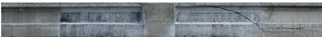
Slika P .3-9: 265-135/65-1: Prikaz prslina nakon loma grede: na južnom (a) i na severnom licu grede (b)
