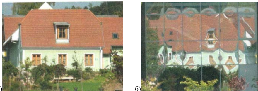
Слика 5.33. Деформација посматране "сlike у огледалу" услед унутрашњег притиска који је допринео дисторзији површине стаклене фасаде (Извор: Neugebauer, 2009: 244)
