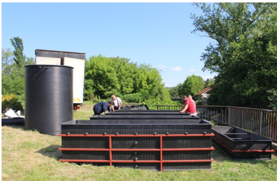
Slika 20. Izgled biološkog sistema
