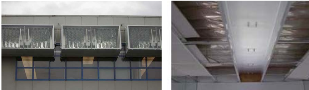
Слика А26. Примјер уграђеног хоризонталног система са спољашње стране, на фасади, слика лијево, и поглед из унутрашњости просторије, слика десно (доступно 10.03.2013. године на сајту http://www.treehugger.com/interior-design/suncentral-computerized-mirror-array-brings-daylight-deep-into-buildings.html )
