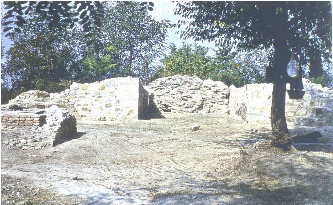
Сл. 114 – Сталаћ, остаци западног бедема Малог града (горе) и зазидана капија кроз кулу II између Великог и Малог града – изглед после конзервације, (Д. Минић и О. Вукадин, Средњовековни Сталаћ, стр. 41.)
