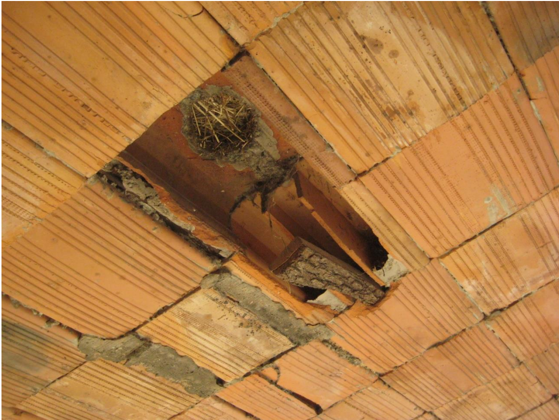
Слика 63: Оштећење међуспратне таванице
