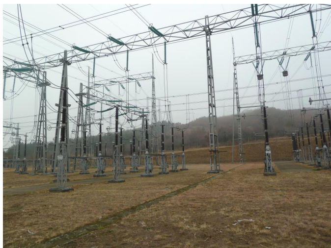
Slika 7.2: Postrojenje 400 kV HE "Đerdap 1"
