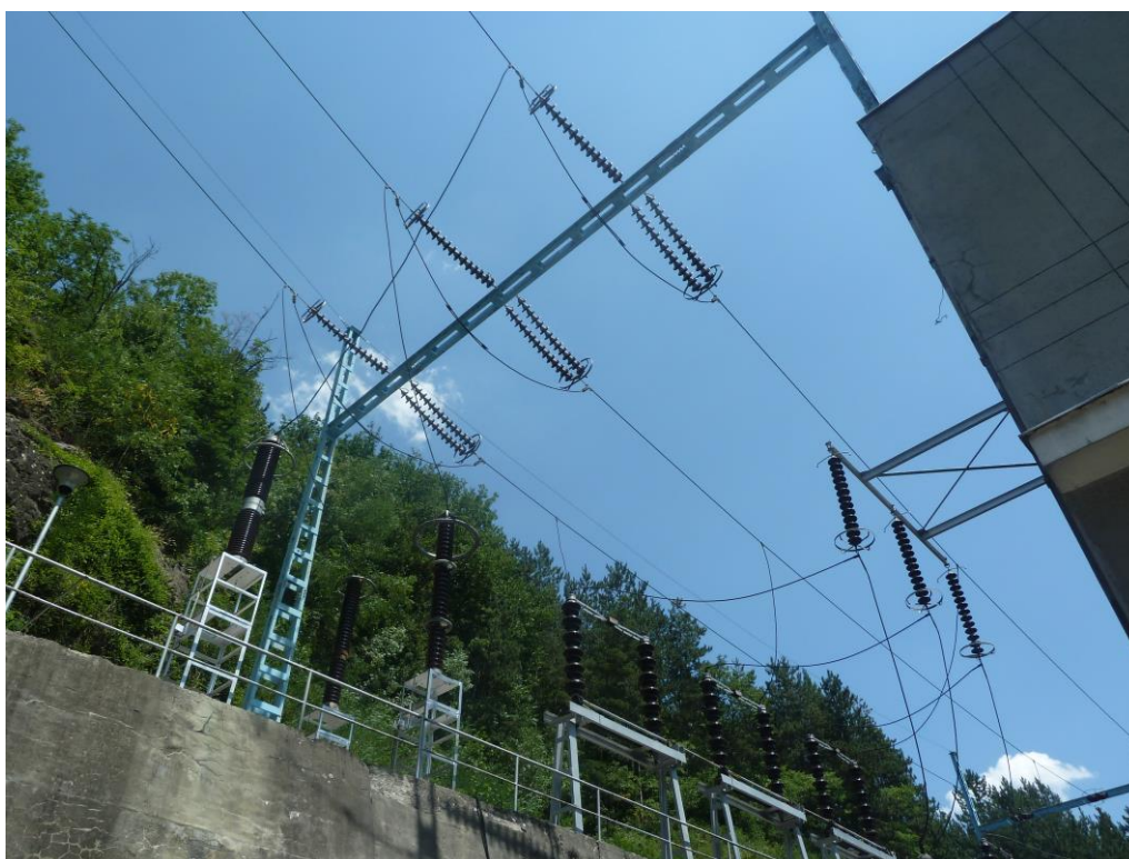
Slika 10.23: Fotografija prihvratnog sistema gromobranske instalacije dela postrojenja 220 kV HE "Bistrica"
