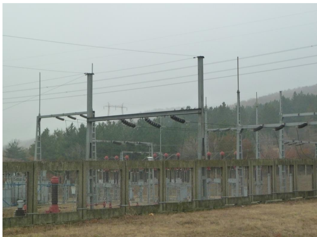
Slika 10.14: Fotografija gromobranskih elemenata (štapnih hvataljki i zaštitne užadi) postrojenja 110 kV HE "Đerdap 1"
