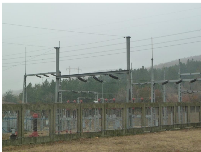
Slika 7.3: Postrojenje 110kV HE "Đerdap 1"
