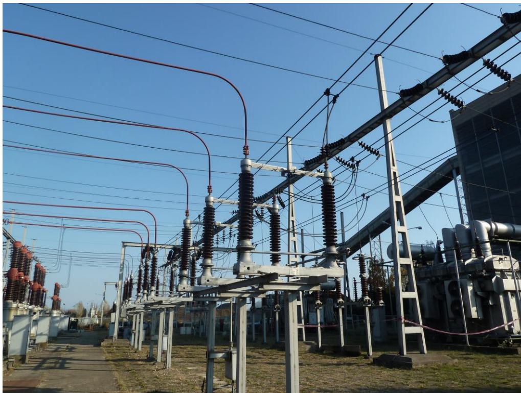
Slika 10.18: Fotografija visokonaponskih elemenata postrojenja 110 kV TE "Morava"
