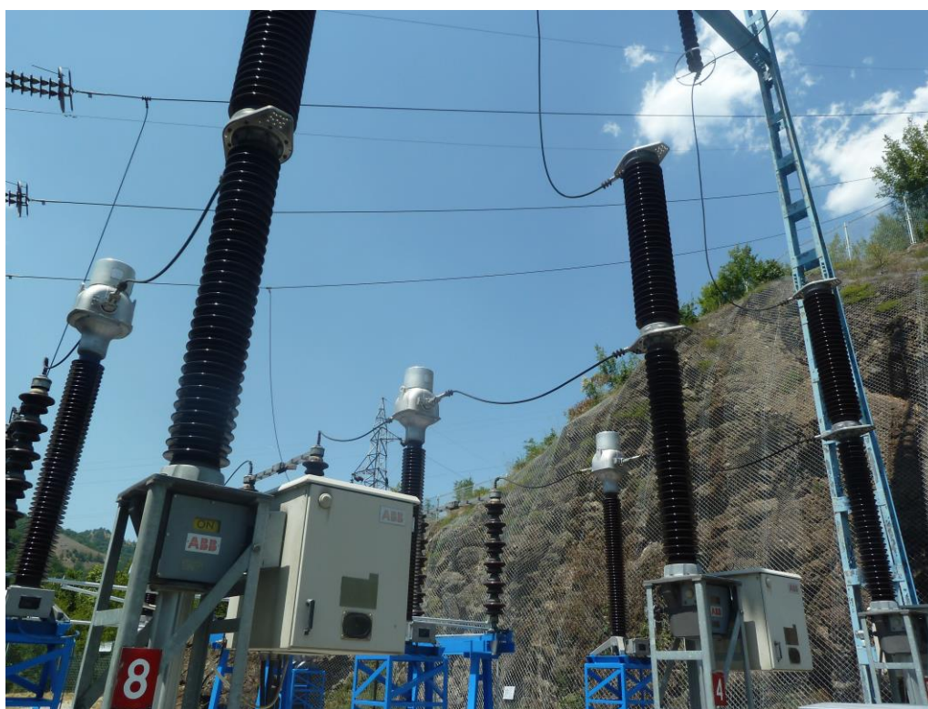
Slika 10.24: Fotografija visokonaponskih elemenata postrojenja 220 kV HE "Bistrica"
