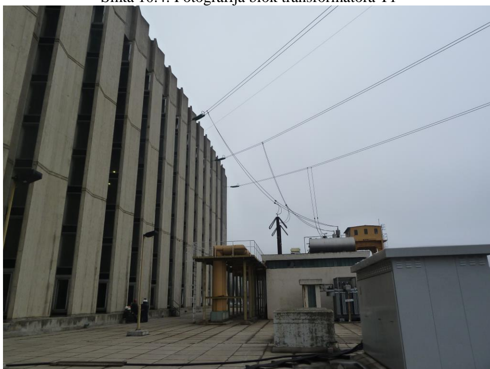
Slika 10.5: Fotografija zaštitnih užadi na mašinskoj zgradi
