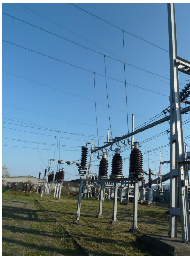
Slika 10.19: Fotografija strujnih i naponskih mernih transformatora na izlazu iz postrojenja 110 kV TE "Morava"
