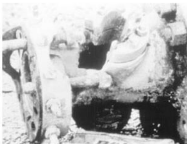
Slika 4.4. Oštećenje ventila usled erozije
