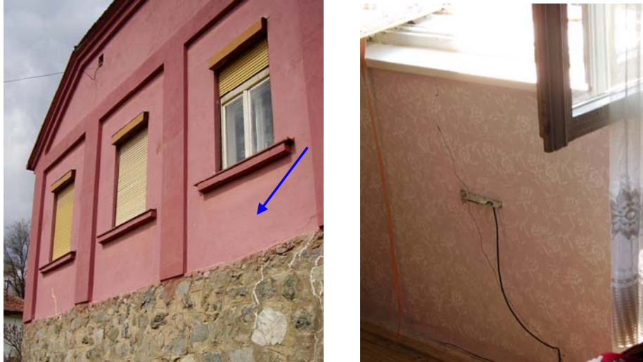
Slika 4-33. Pukotina 1 sa spoljne strane kuće (levo) i položaj senzora na pukotini 1 (desno)[105]
