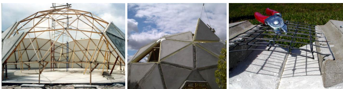
Слика 77. Монтирање префабрикованих троугаоних сендвич панела на привремене скеле и увезивање мрежа испуштених из панела. [Преузето са http://www.aidomes.com/construction-overview/27/article , 14.10.2012.]
